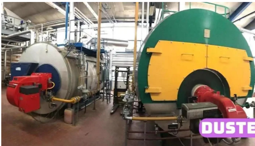
Kazep kazanjavito es szerel? kft oroshaza
